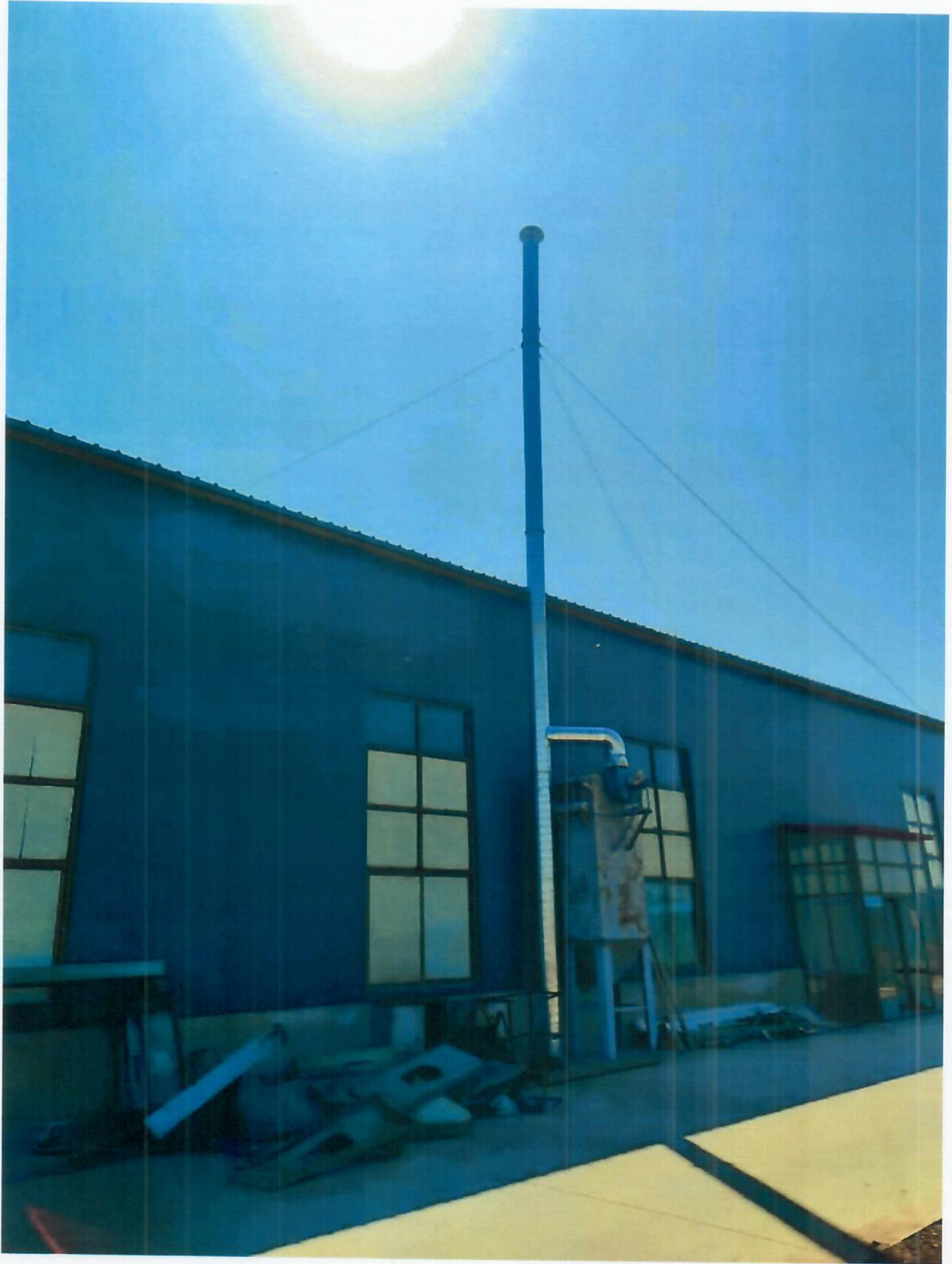
布袋除尘器+排气筒
